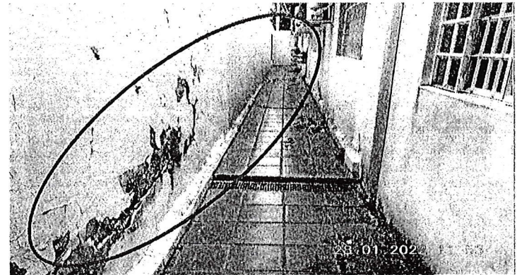
FOTO 22: Risco de queda de revestimento
