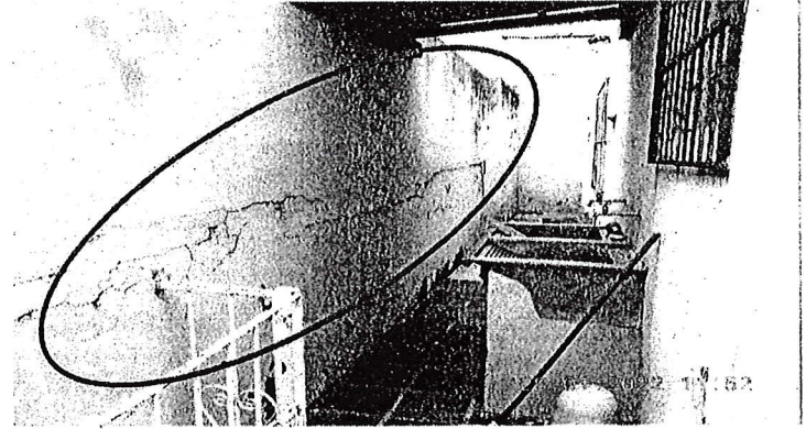
FOTO 20: Risco de queda de revestimento
