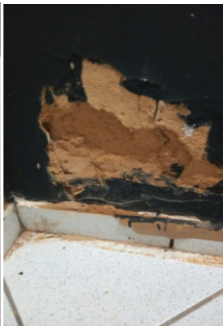
REBOCO DESAGREGANDO ESCRITÓRIO 5
