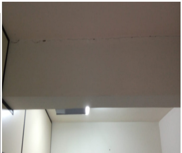
FISSURA VIGA/TETO LAJE
