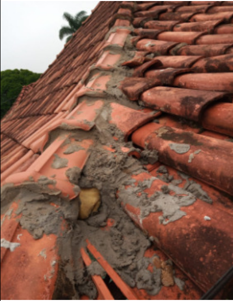
ERRO APLICAÇÃO CAPA TELHA
