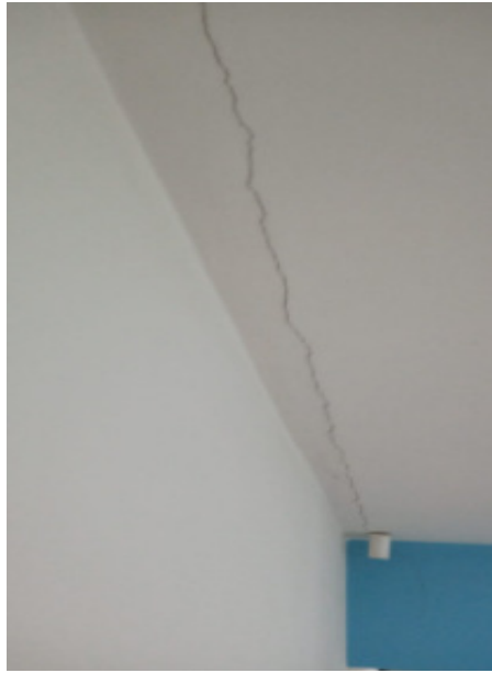
FISSURA TETO LAJE
