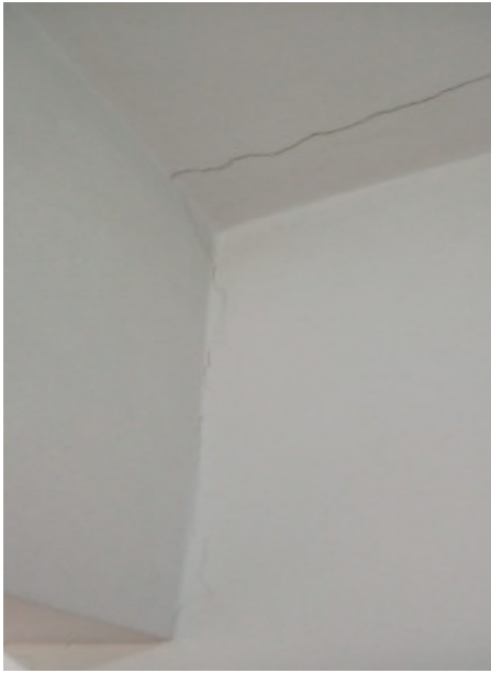
FISSURA TETO LAJE
