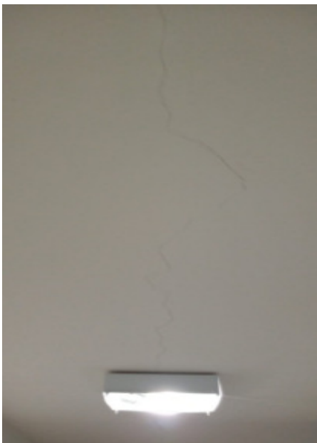
FISSURA TETO LAJE
