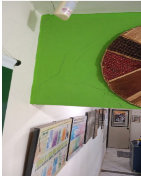
FISSURA CONTRA VERGA PORTA
