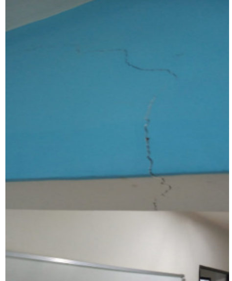
FISSURA CONTRA VERGA PORTA
