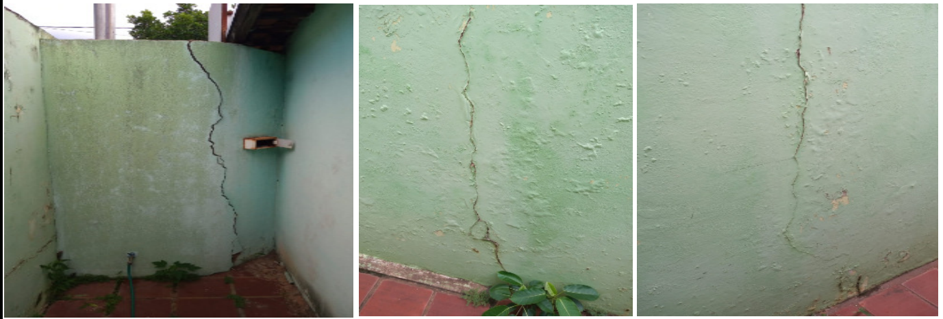
RACHADURA EM MURO
