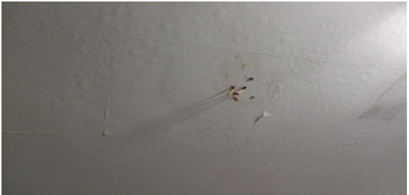
FISSURA/INFILTRAÇÃO TETO LAJE
