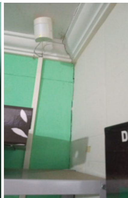
FISSURA QUINA PAREDE
