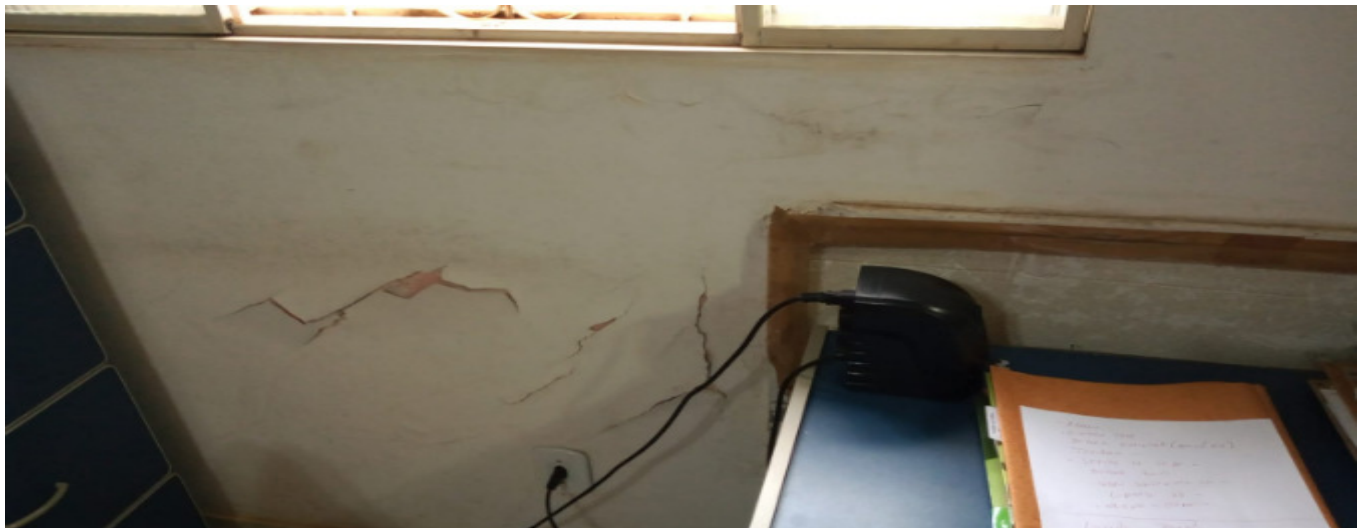
FISSURA/INFILTRAÇÃO E PINTURA DESCASCANDO
