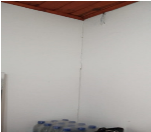
FISSURA QUINA PAREDE
