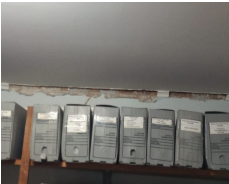
INFILTRAÇÃO FORRO GESSO
