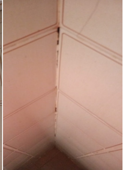
FISSURA QUINA PAREDE
