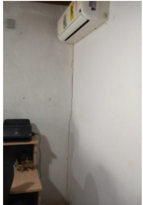
FISSURA QUINA PAREDE
