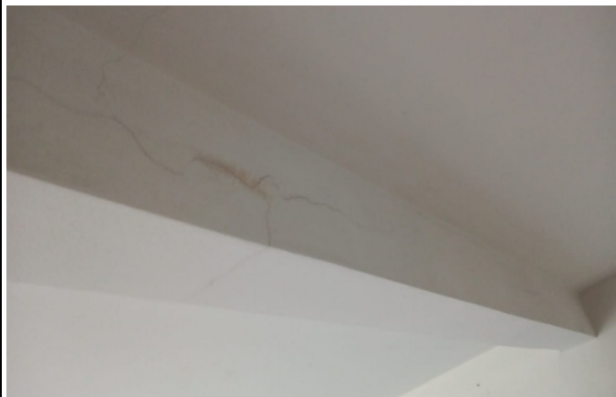
FISSURA EM VIGA
