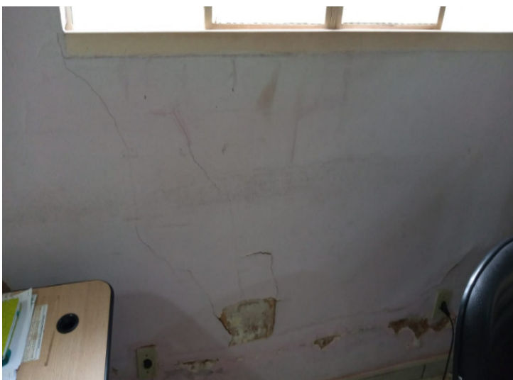
FISSURA/INFILTRAÇÃO E PINTURA DESCASCANDO
