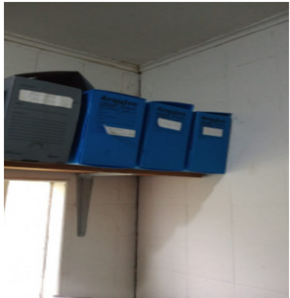
FISSURA QUINA PAREDE
