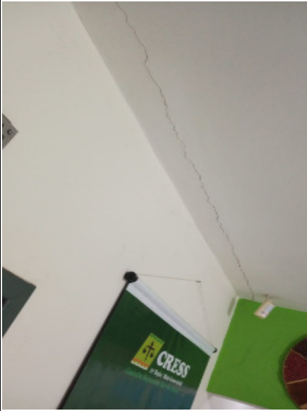
FISSURA TETO LAJE
