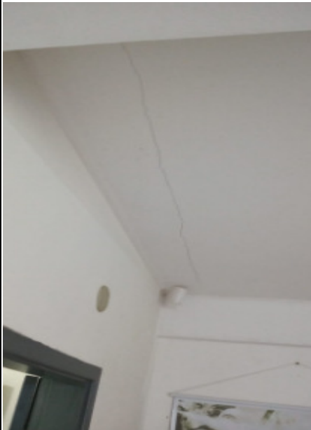
FISSURA TETO LAJE
