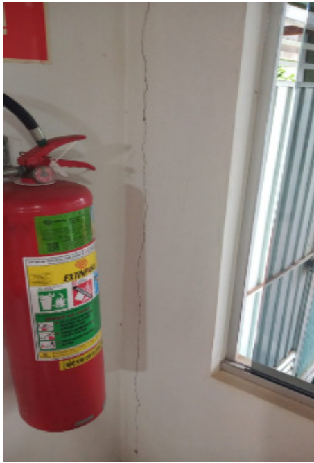
FISSURA QUINA PAREDE
