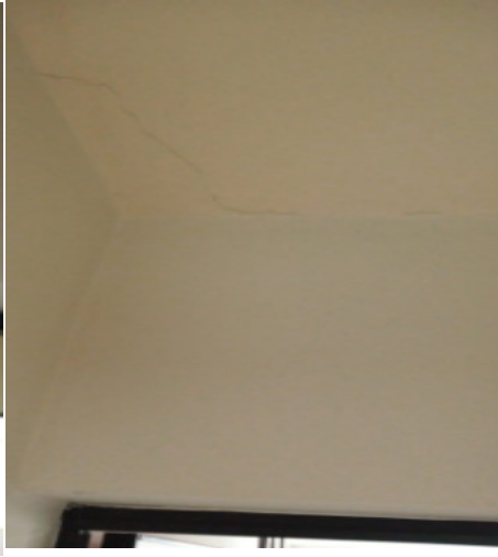
FISSURA TETO LAJE
